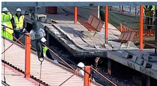
Hundimiento del Andén de RENFE en Bellvitge
