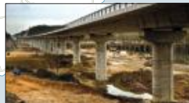
4. Viaducto sobre la riera de Santa Coloma que permite superar la riera, una carretera, vías y una estación del tren convencional.
