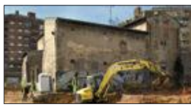
2. Obras junto a la torre del Fang, en el barrio barcelonés de Sagrera. El edificio, con elementos medievales, se salva en una operación compleja.
