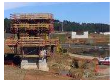
+ Una imatge dels treballs des de la banda de Sant Julià, la setmana passada. Foto: R.E.
