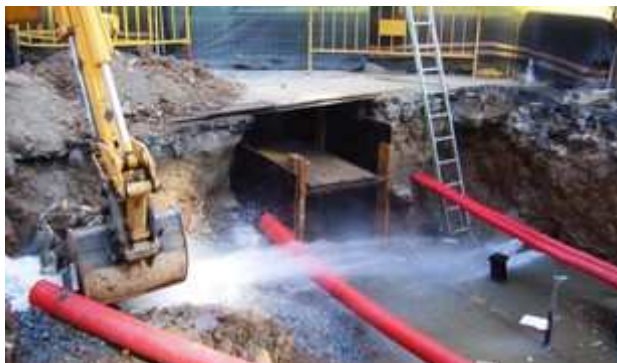
La fuga d'aigua provocada per les obres del TAV al Clot. Foto: EL PUNT.
