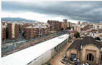
El calaix de formigó que cobreix les vies de la L-1 del metro a Sants a l'altura de la Riera de Tena, divendres. Foto: ALBERT BERTRAN
