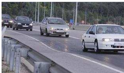
El tram té un desnivell d'uns vint centímetres repartits entre els quinze metres del ferm afectat. marc martí
