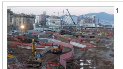
Una imatge d'arxiu de les obres que ja s'estan duent a terme a l'àmbit on es construirà la nova estació. Foto: QUIM PUIG.
